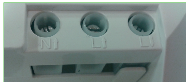
Bornas para la conexión del cableado
